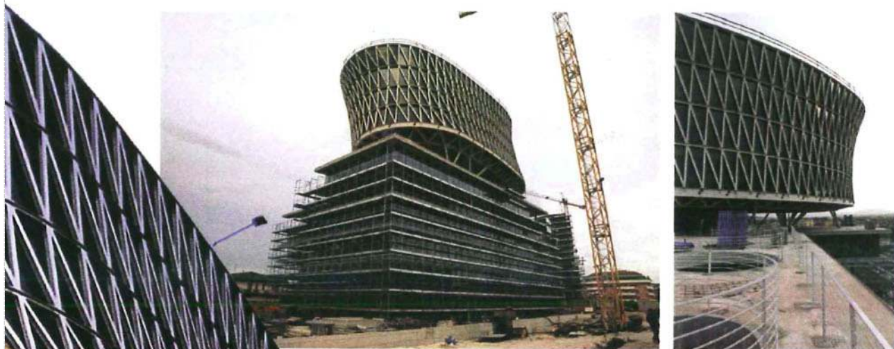
Immagini 1a, b. Articolazione concettuale e morfo-tipologica. L'innesto tra le sagome del corpo ortogonale e del "composto" architettonico a curvatura concava (distaccato mediante i tripodi in tubi di acciaio, sostenuto dalla struttura anulare in acciaio; 1a), esprime il carattere dell'artefatto "intermodale", dovuto alle intersezioni e transizioni tra gli elementi dell'involucro secondo forme "multi-lineari" (1b)
