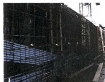
Particolare dei cavi alloggiati all'interno della gabbia metallica.
