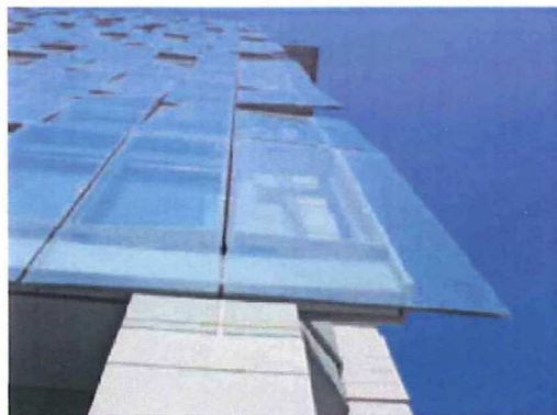
Grazie al funzionamento automatico delle veneziane interne e dei ventilatori, il calore accumulato nell'aria presente nell'intercapedine viene allontanato, diminuendo il carico termico e l'asimmetria radiante degli uffici
